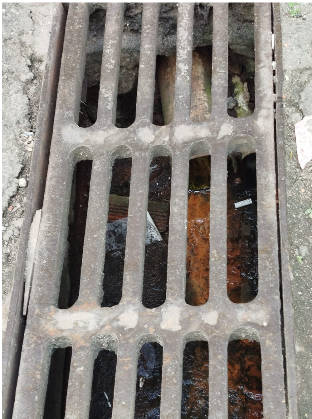
Imagem 4 – Vista da boca de lobo, Rua Guarani I, s/n, Laranjeiras Velha, Serra/ES Fonte: Gabinete.
