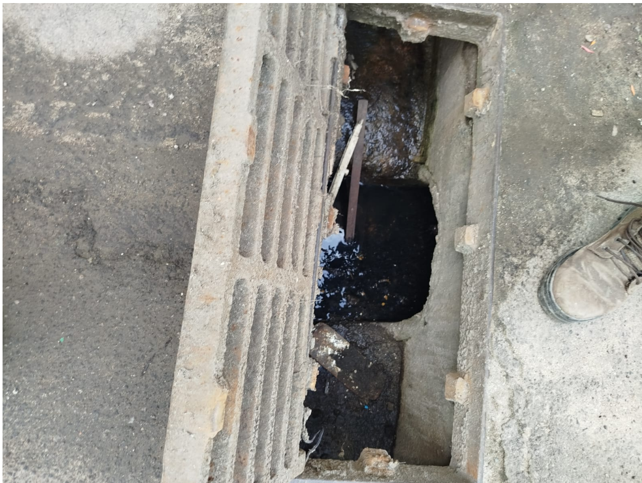
Imagem 2 – Vista da da Rua Guarani I, s/n, Laranjeiras Velha, Serra/ES. Fonte: Gabinete.
