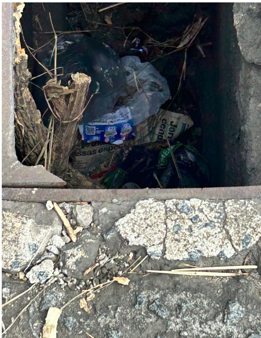
Imagem 2 - Boca de Lobo obstruída na Rua Casimiro de Abreu, s/n, Parque Residencial Laranjeiras, Serra/ES. Fonte: Gabinete.
