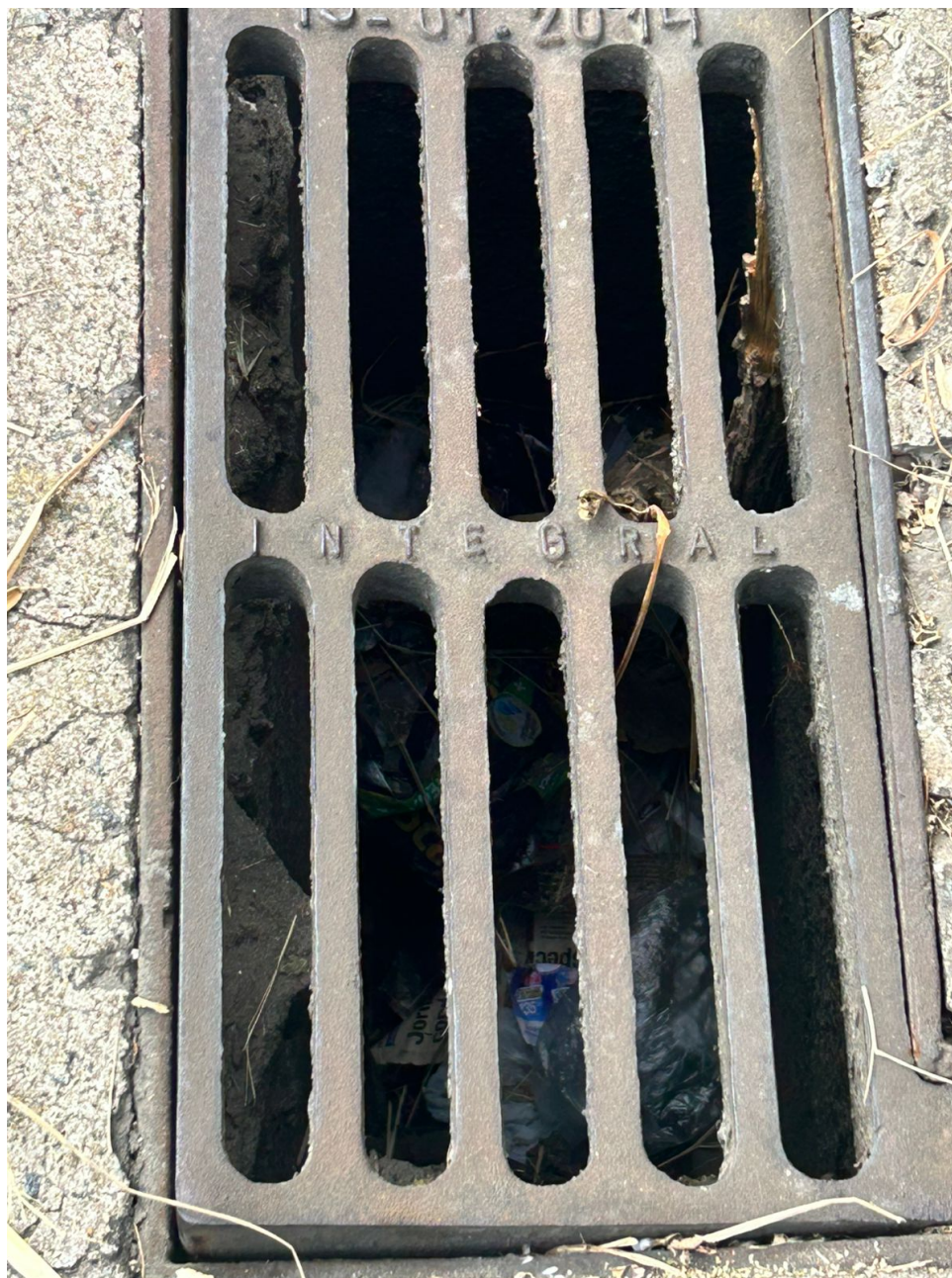
Imagem 3 - Boca de Lobo obstruída na Rua Casimiro de Abreu, s/n, Parque Residencial Laranjeiras, Serra/ES. Fonte: Gabinete.
