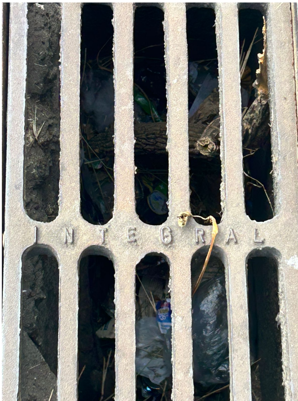
Imagem 4 - Boca de Lobo obstruída na Rua Casimiro de Abreu, s/n, Parque Residencial Laranjeiras, Serra/ES. Fonte: Gabinete.
