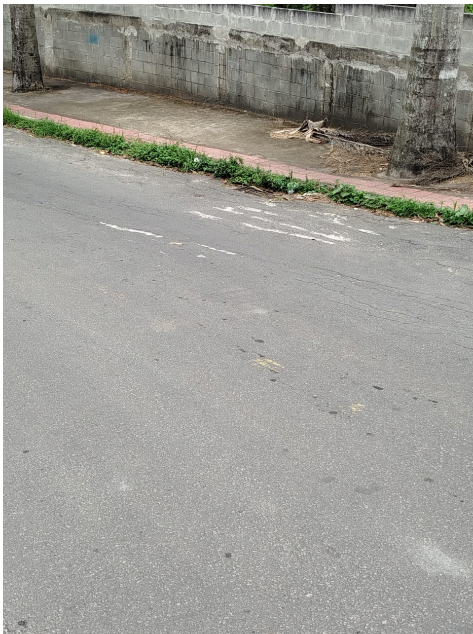
Imagem 3 - Vista da Rua Beija Flor II, s/n, Taquara I, Serra/ES. Fonte: Gabinete
