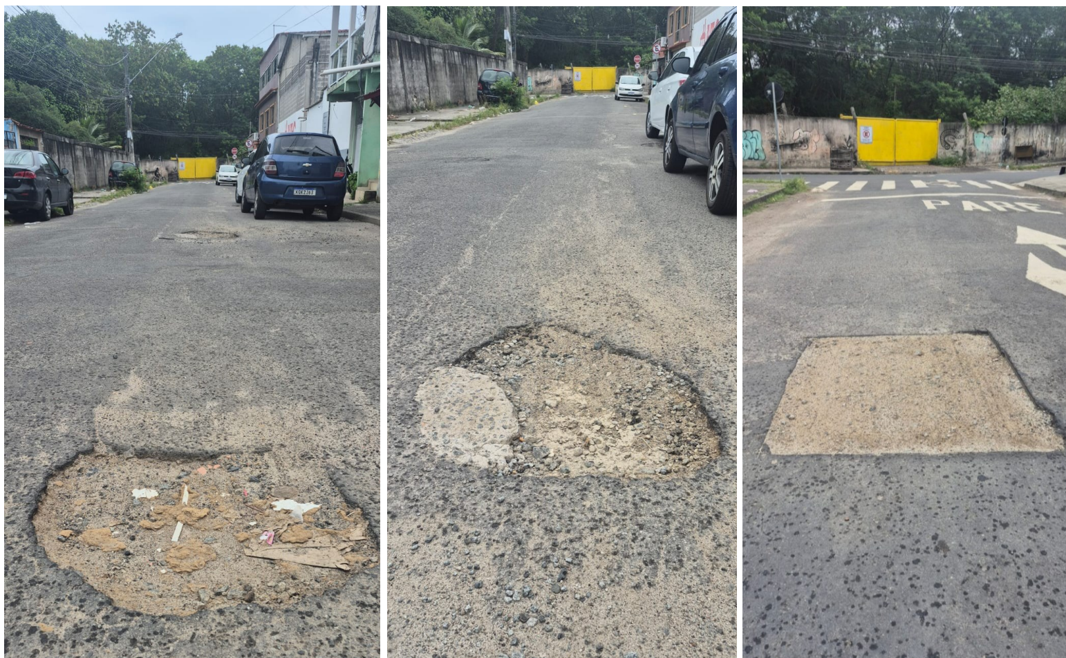
(Buracos na Rua Tucano)
