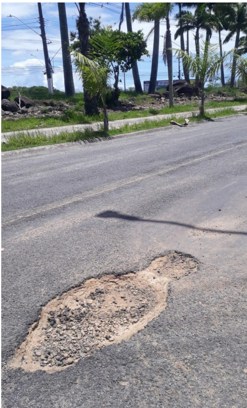
Imagem 2 - Vista da Rua Girassol, s/n, Manguinhos, (Loteamento Yahoo Residence), Serra - ES. Fonte: Gabinete.
