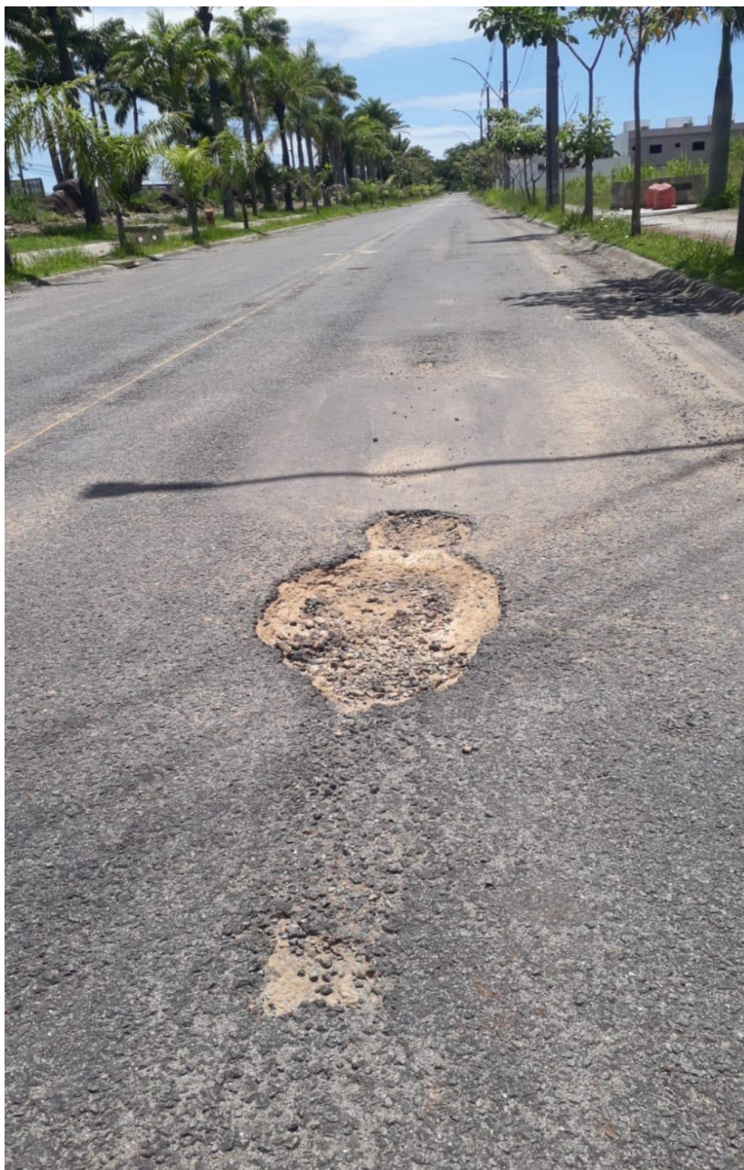
Imagem 3 - Vista da Rua Girassol, s/n, Manguinhos, (Loteamento Yahoo Residence), Serra - ES. Fonte: Gabinete.
