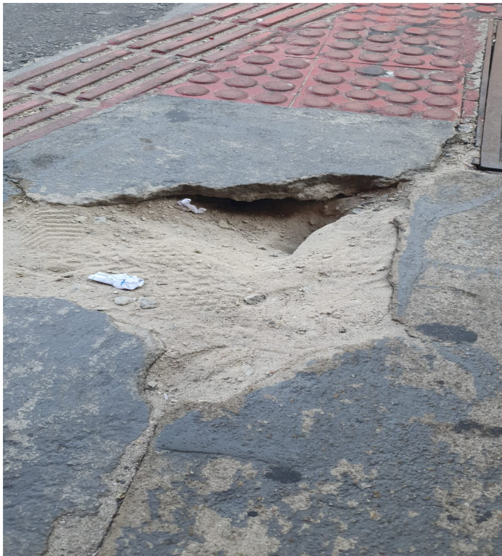
Imagem 2 - Vista da calçada deteriorada, localizada na Av. Central. Fonte: Gabinete.
