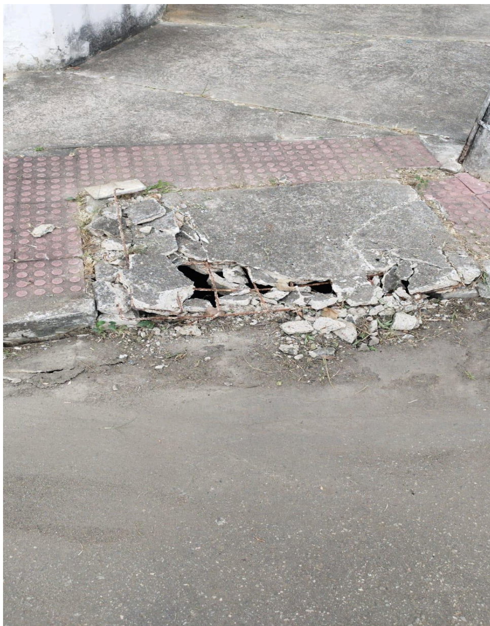
Imagem 2 - Vista da Tampa, Rua Monte Sinai, S/N, Colina de Laranjeiras, Serra - ES. Fonte: Gabinete.
