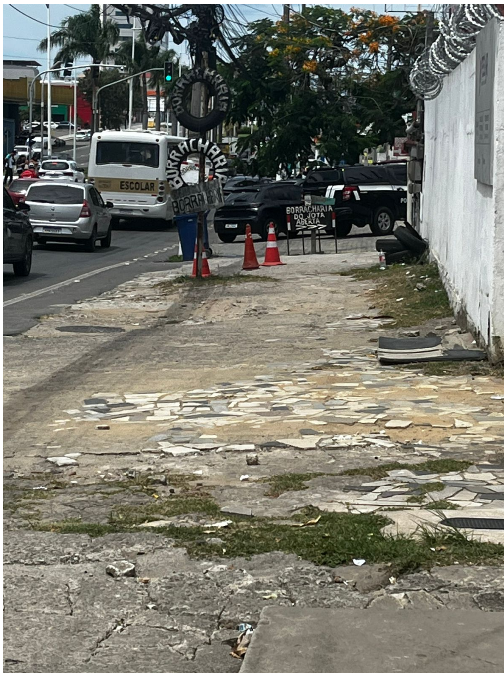
Imagem 3 - Vista da calçada sem ciclovia na Avenida Eldes Scherrer, s/n, Parque residencial Laranjeiras, Serra-ES.
