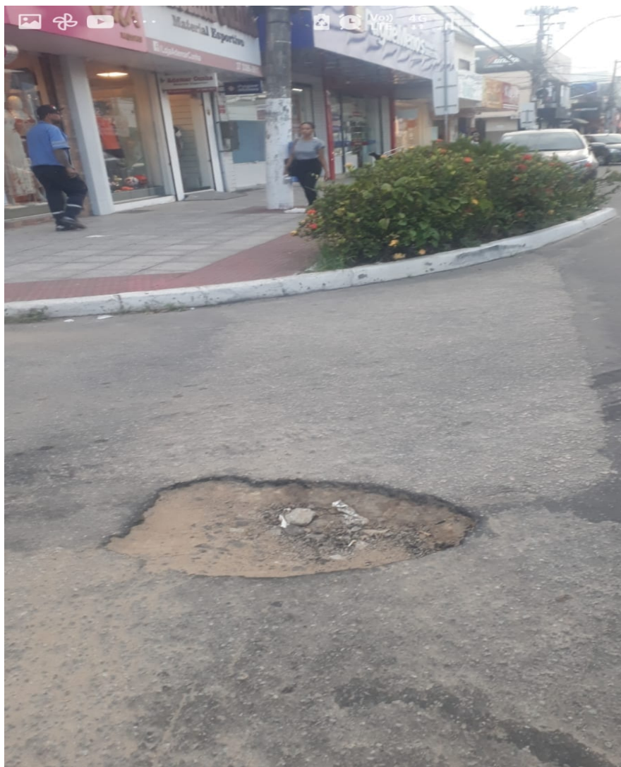
Imagem 2 - Vista do buraco na Avenida Central, N° 508, Parque Residencial Laranjeiras, Serra - ES. Fonte: Gabinete.
