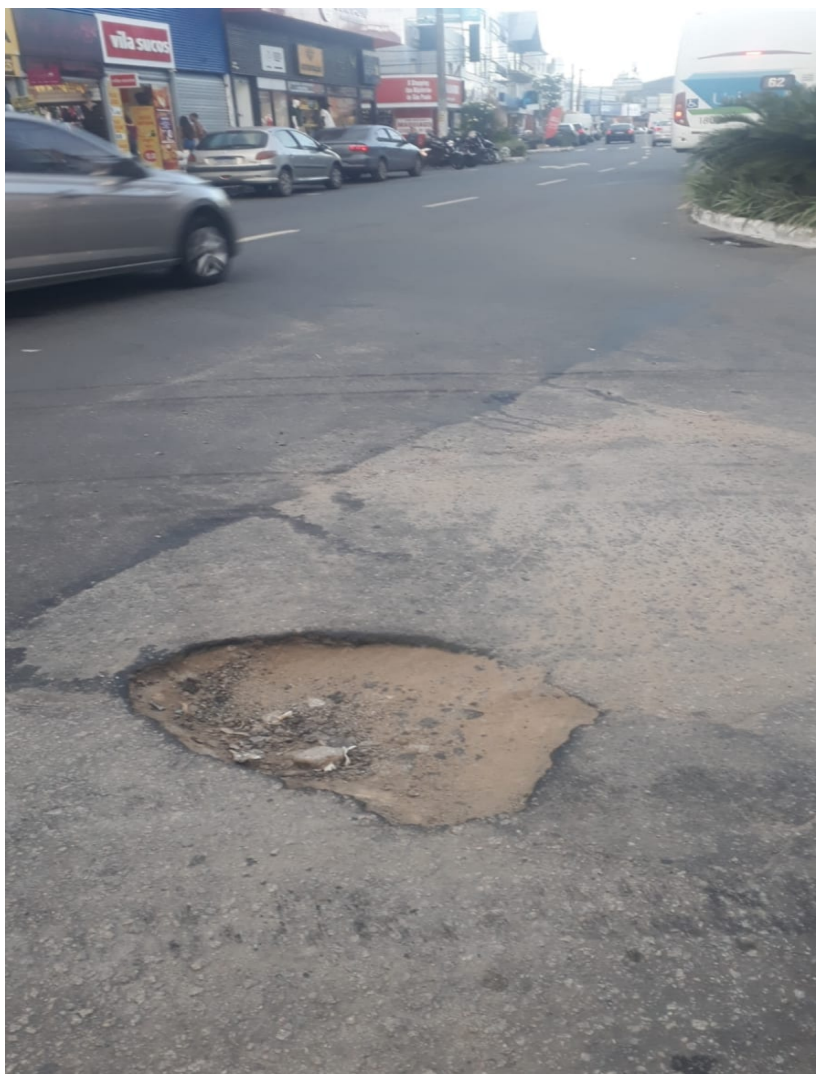
Imagem 3 - Vista do buraco na Avenida Central, N° 508, Parque Residencial Laranjeiras, Serra - ES. Fonte: Gabinete.
