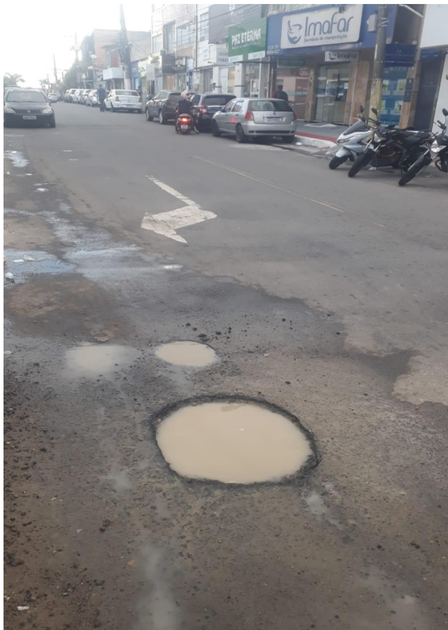
Imagem 2 - Vista do buraco, Rua Álvares Cabral, s/n, Parque Residencial Laranjeiras, Serra - ES. Fonte: Gabinete.
