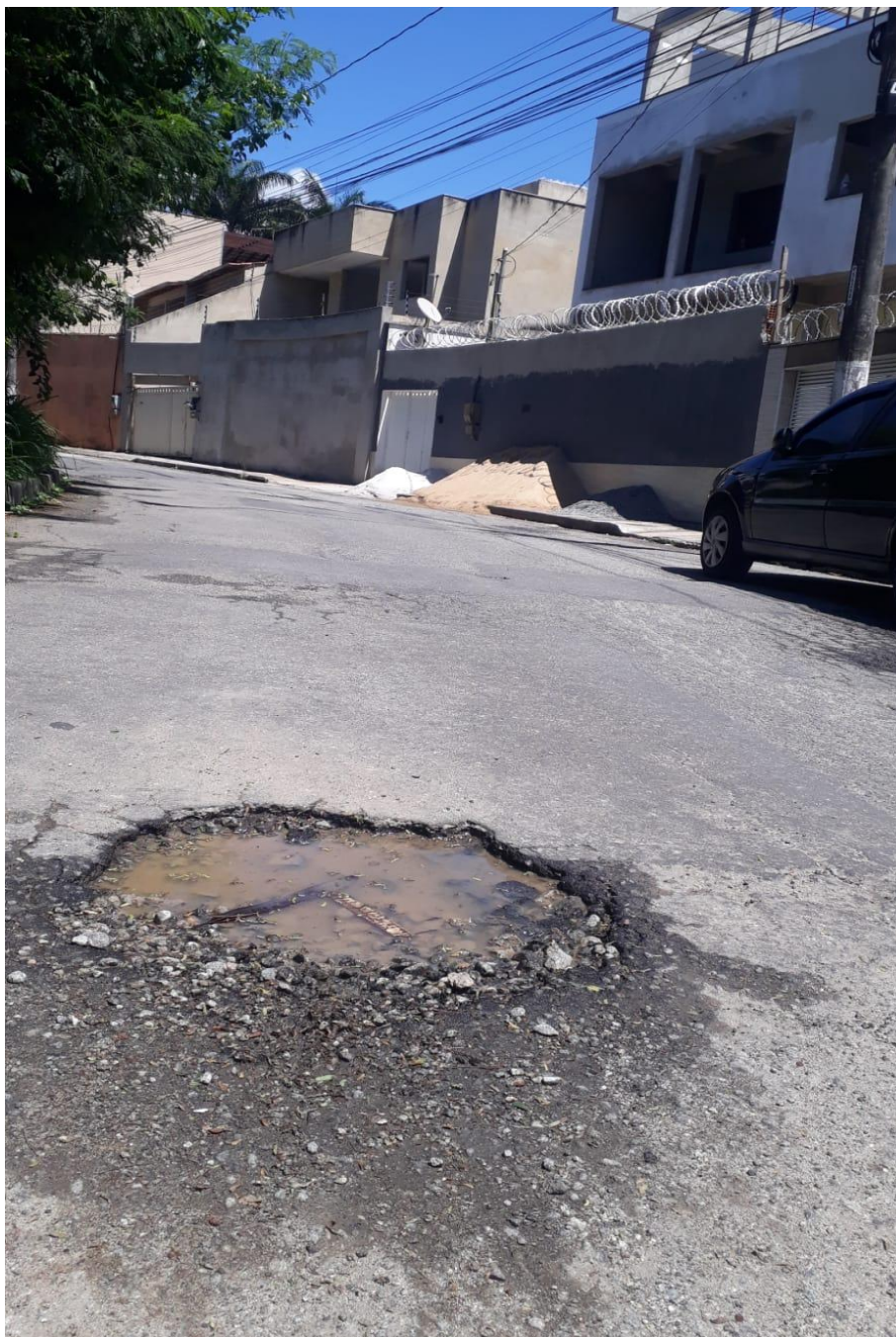
Imagem 4 - Vista do buraco na Rua Monte Moriá, s/n, Colina de Laranjeiras, Serra - ES. Fonte: Gabinete.
