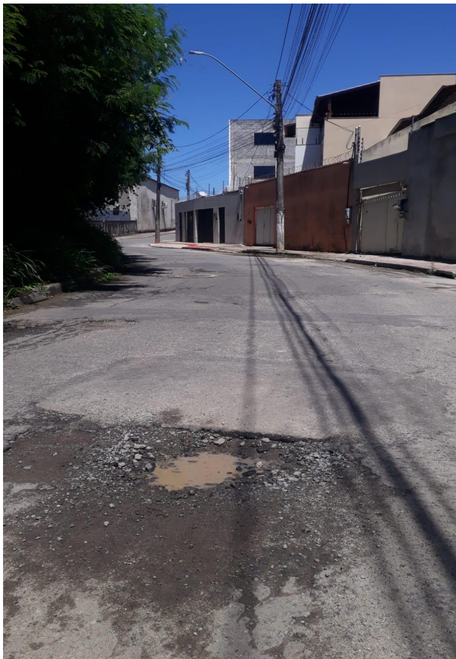
Imagem 3 - Vista do buraco na Rua Monte Moriá, s/n, Colina de Laranjeiras, Serra - ES. Fonte: Gabinete.
