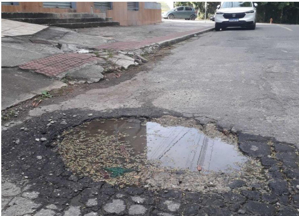
Imagem 2 - Vista do buraco na Rua Monte Moriá, s/n, Colina de Laranjeiras, Serra - ES. Fonte: Gabinete.
