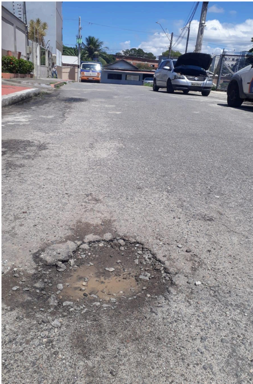
Imagem 2 - Vista do buraco na Rua Monte Ararate, s/n, Colina de Laranjeiras, Serra - ES. Fonte: Gabinete.
