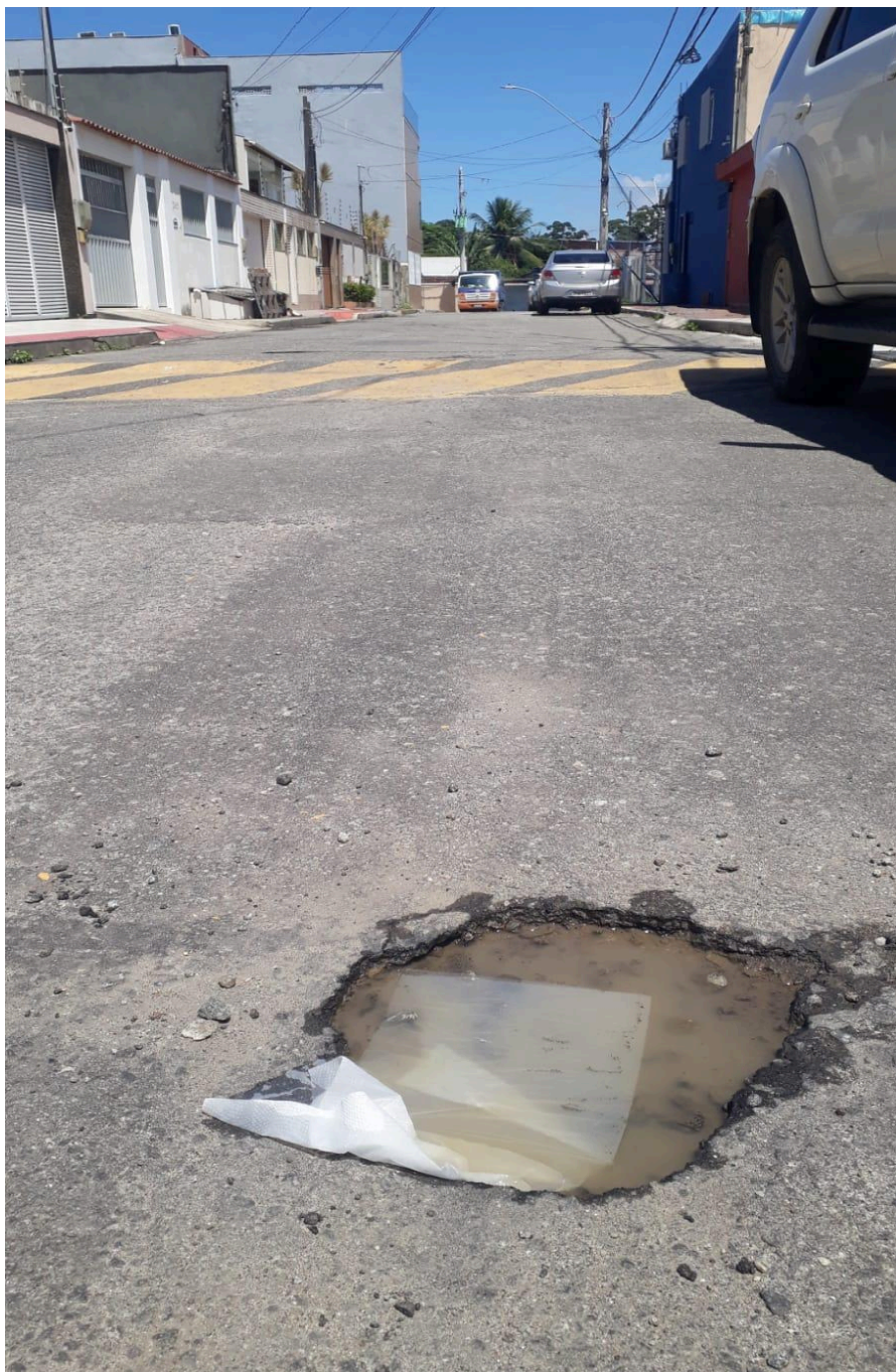
Imagem 3 - Vista do buraco na Rua Monte Ararate, s/n, Colina de Laranjeiras, Serra - ES. Fonte: Gabinete.
