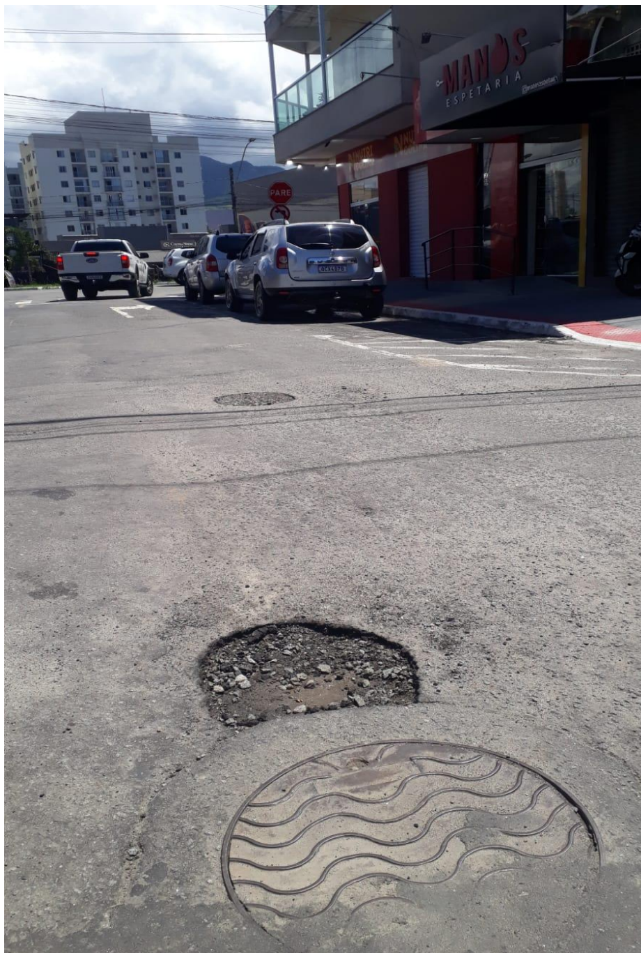
Imagem 4 - Vista do buraco na Avenida Mestre Álvaro, s/n, Colina de Laranjeiras, Serra - ES. Fonte: Gabinete.
