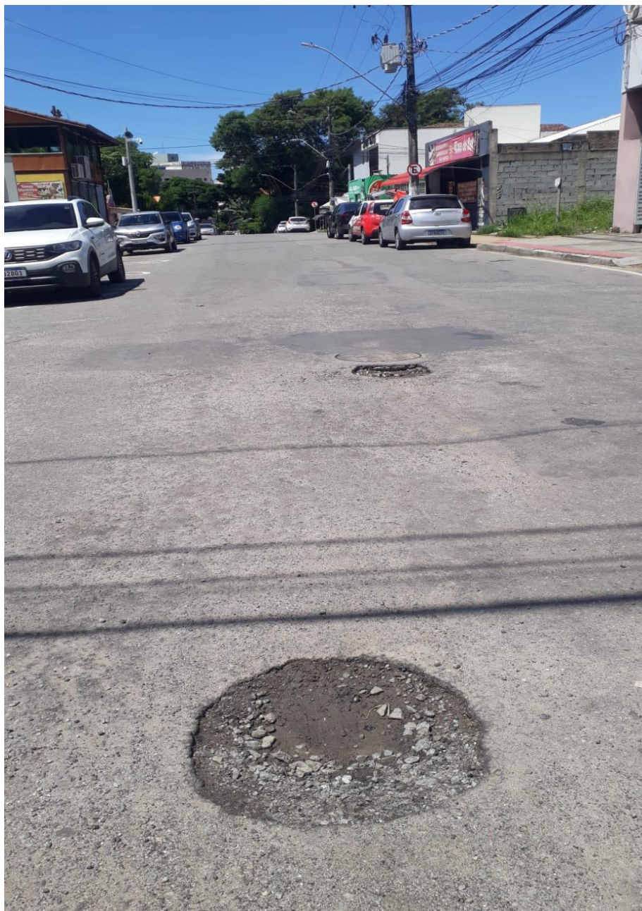
Imagem 3 - Vista do buraco na Avenida Mestre Álvaro, s/n, Colina de Laranjeiras, Serra - ES. Fonte: Gabinete.
