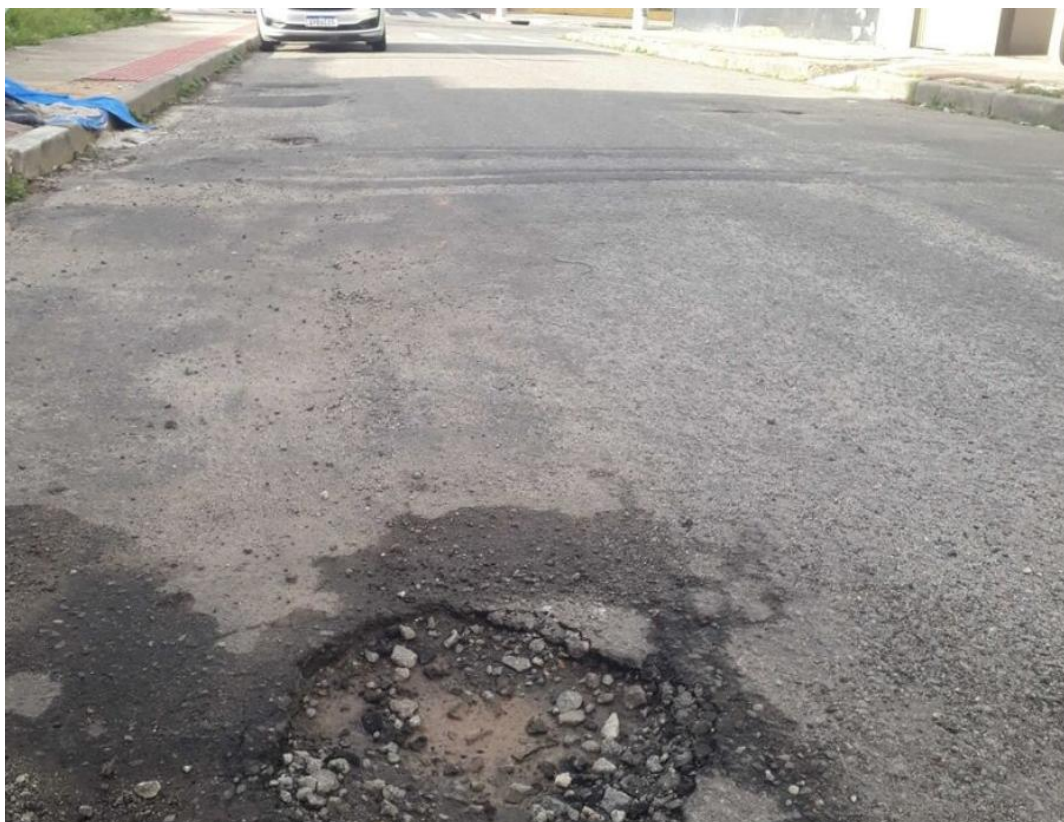
Imagem 2 - Vista do buraco na Rua Monte Belo, Bairro Colina de Laranjeiras, Serra - ES. Fonte: Gabinete.
