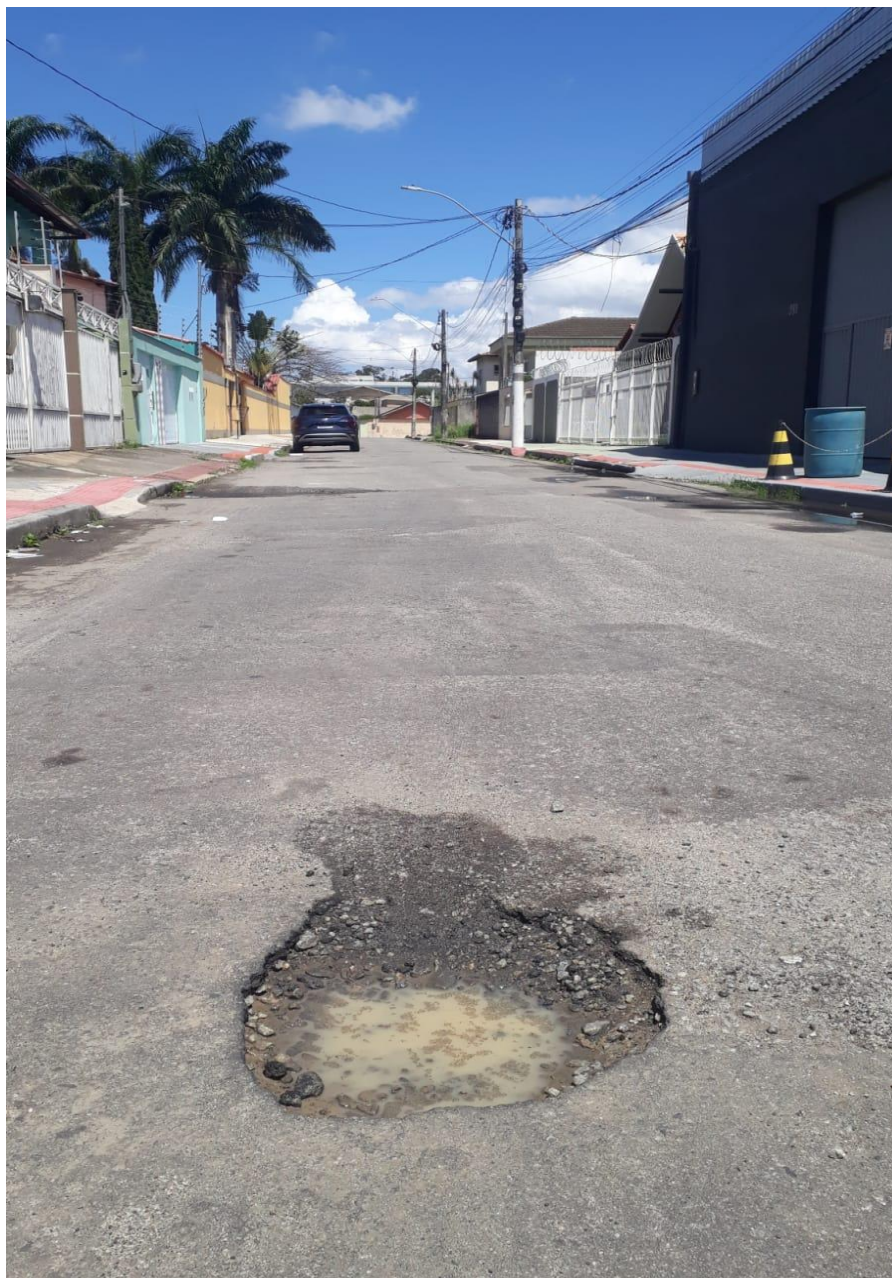
Imagem 4 - Vista do buraco na Rua Monte Belo, Bairro Colina de Laranjeiras, Serra - ES. Fonte: Gabinete.
