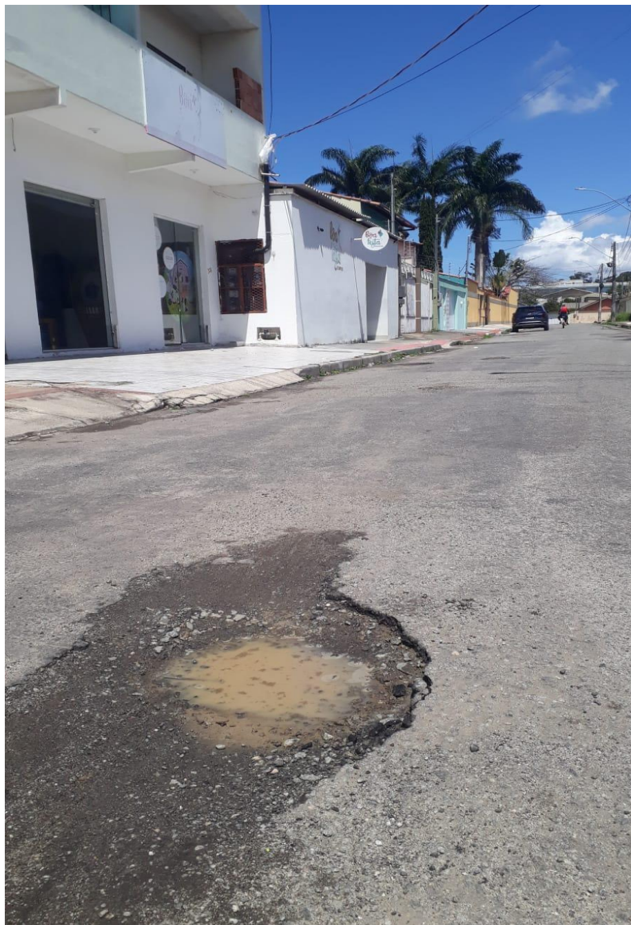
Imagem 3 - Vista do buraco na Rua Monte Belo, Bairro Colina de Laranjeiras, Serra - ES. Fonte: Gabinete.
