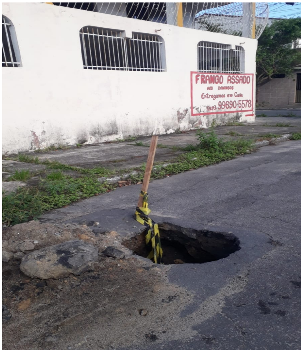
Imagem 4 - Vista do buraco da Rua Guilherme de Almeida, N°134, Chácara Parreiral, Serra - ES. Fonte: Gabinete.
