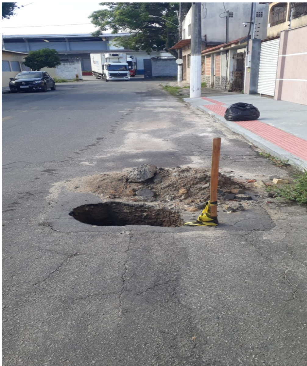
Imagem 2 - Vista do buraco da Rua Guilherme de Almeida, N°134, Chácara Parreiral, Serra - ES. Fonte: Gabinete.
