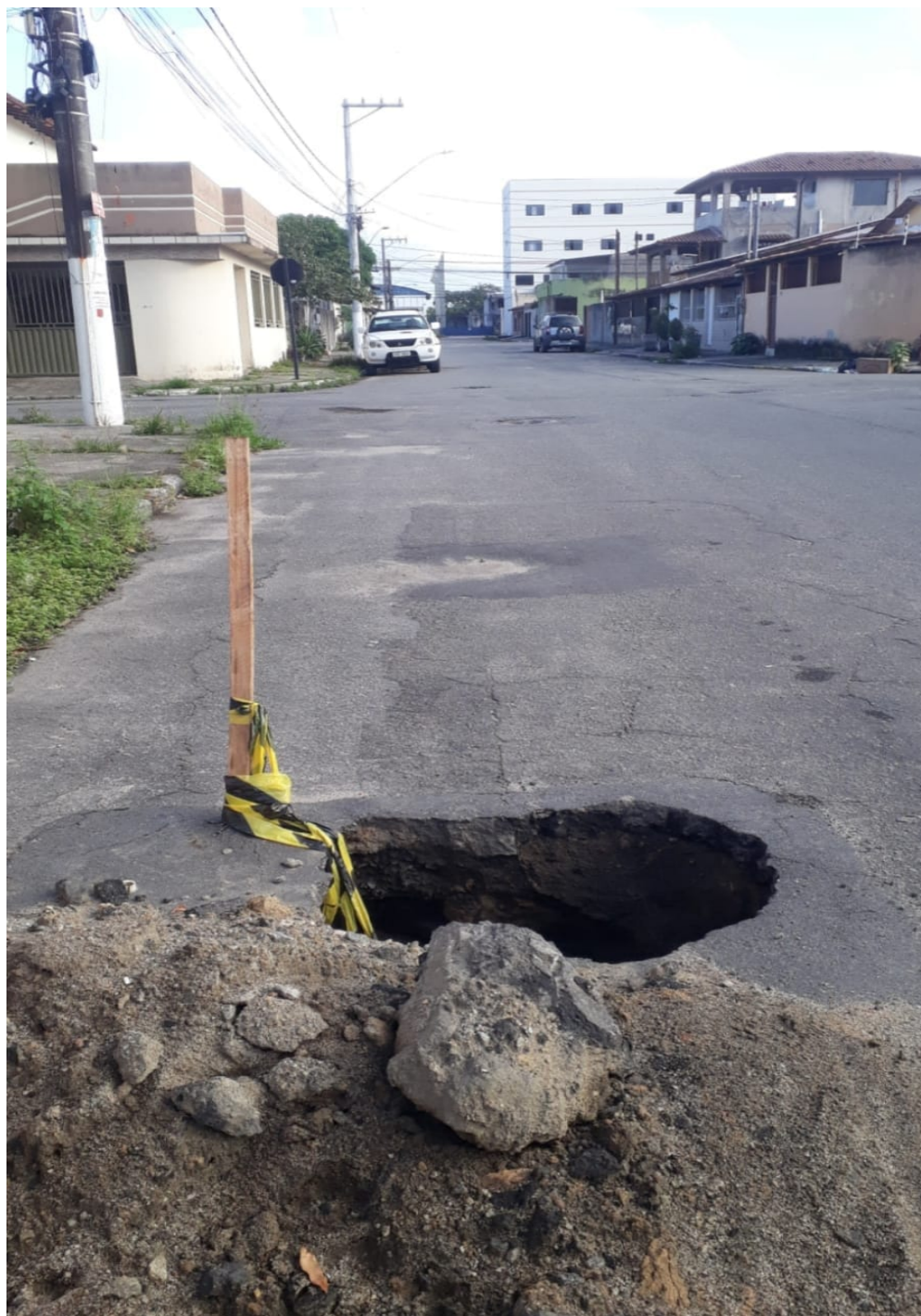
Imagem 3 - Vista do buraco da Rua Guilherme de Almeida, N°134, Chácara Parreiral, Serra - ES. Fonte: Gabinete.
