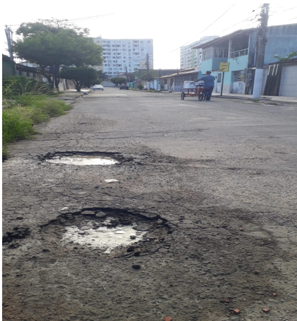
Imagem 2 - Vista do buraco da Rua Guilherme de Almeida, N°134, Chácara Parreiral, Serra - ES. Fonte: Gabinete.
