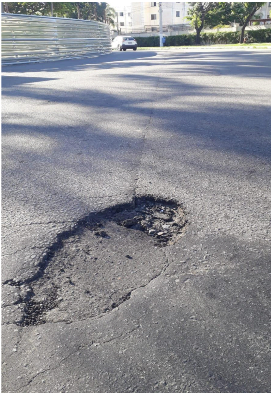
Imagem 2 - Vista do buraco Rua Dom Pedro II, s/n, Colina de Laranjeiras, Serra - ES. Fonte: Gabinete.
