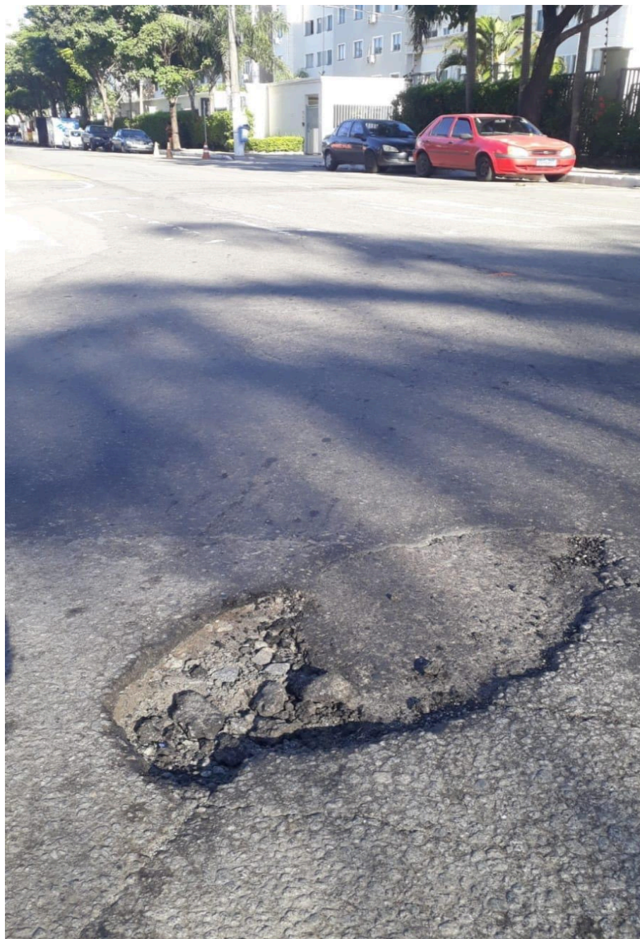
Imagem 3 - Vista do buraco Rua Dom Pedro II, s/n, Colina de Laranjeiras, Serra - ES. Fonte: Gabinete.
