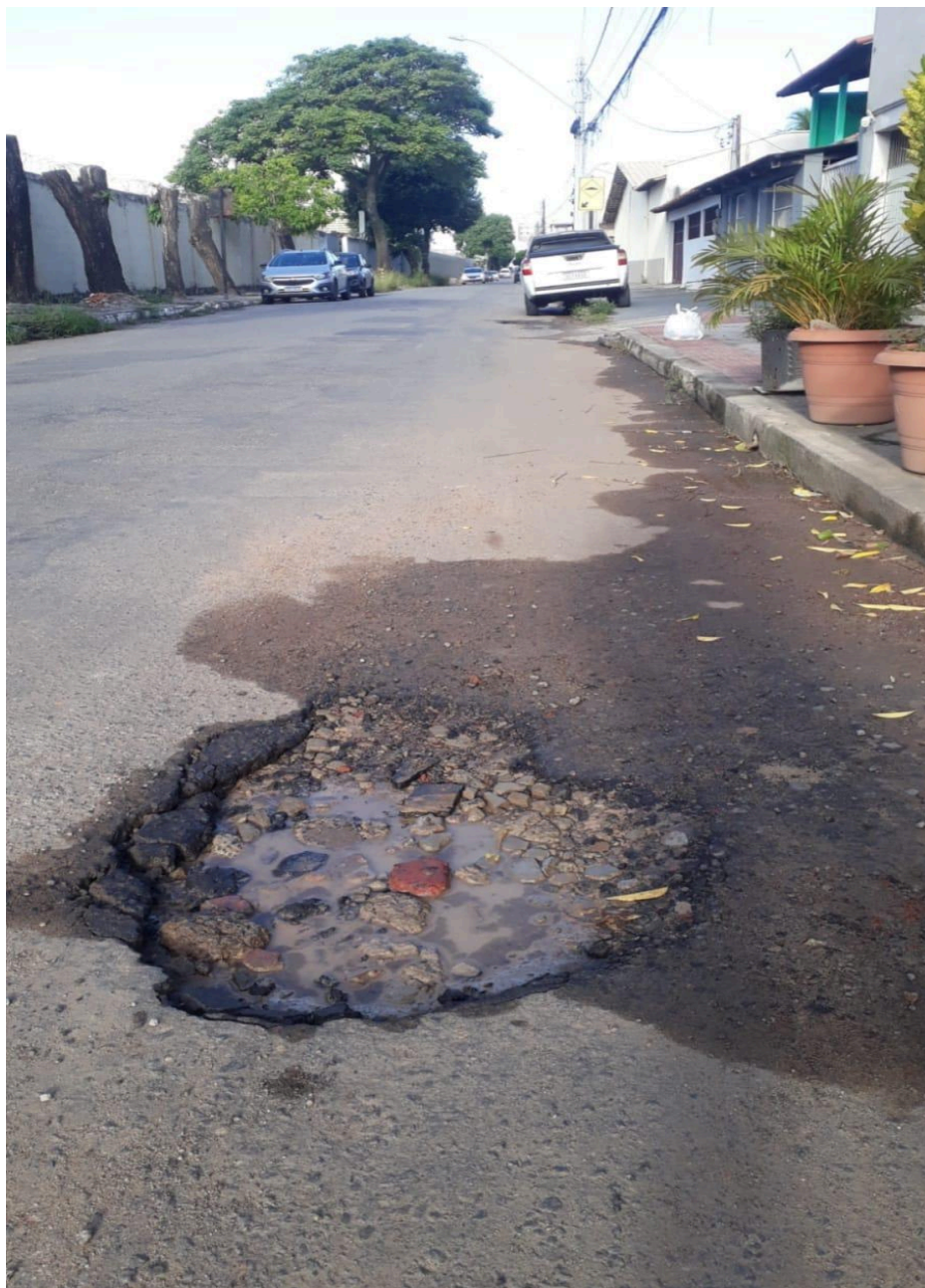
Imagem 2 - Vista do buraco Rua Raimundo Corrêa, s/n ,Chácara Parreiral, Serra - ES. Fonte: Gabinete.
