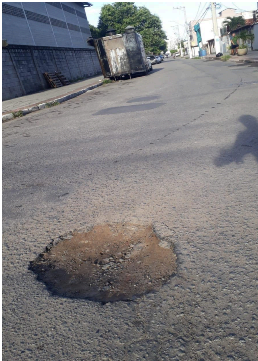
Imagem 3 - Vista do buraco Rua Raimundo Corrêa, s/n ,Chácara Parreiral, Serra - ES. Fonte: Gabinete.
