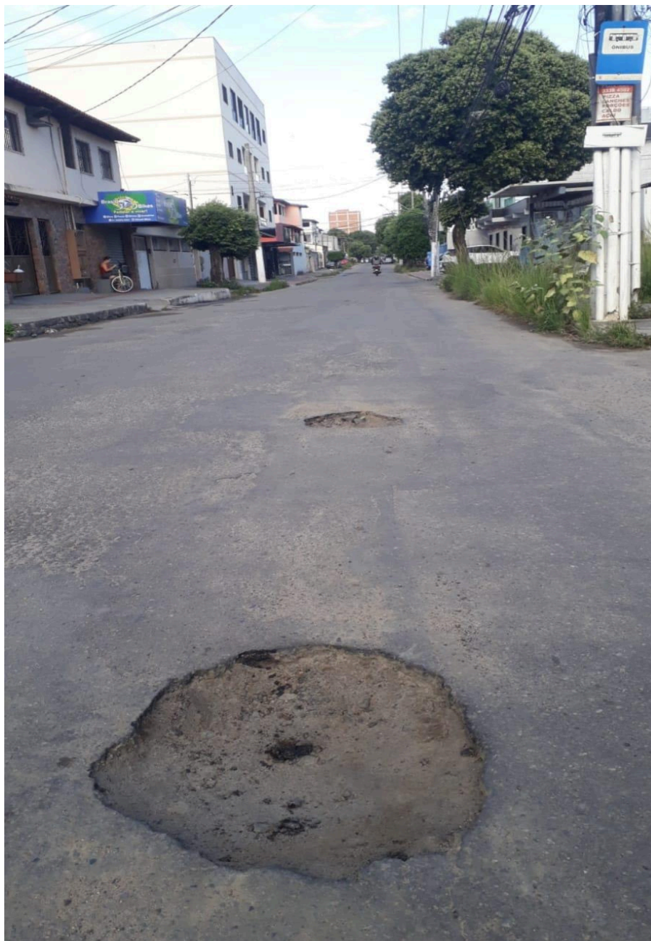
Imagem 2 - Vista do buraco, Rua Gustavo Barroso, s/n, Chácara Parreiral, Serra - ES. Fonte: Gabinete.
