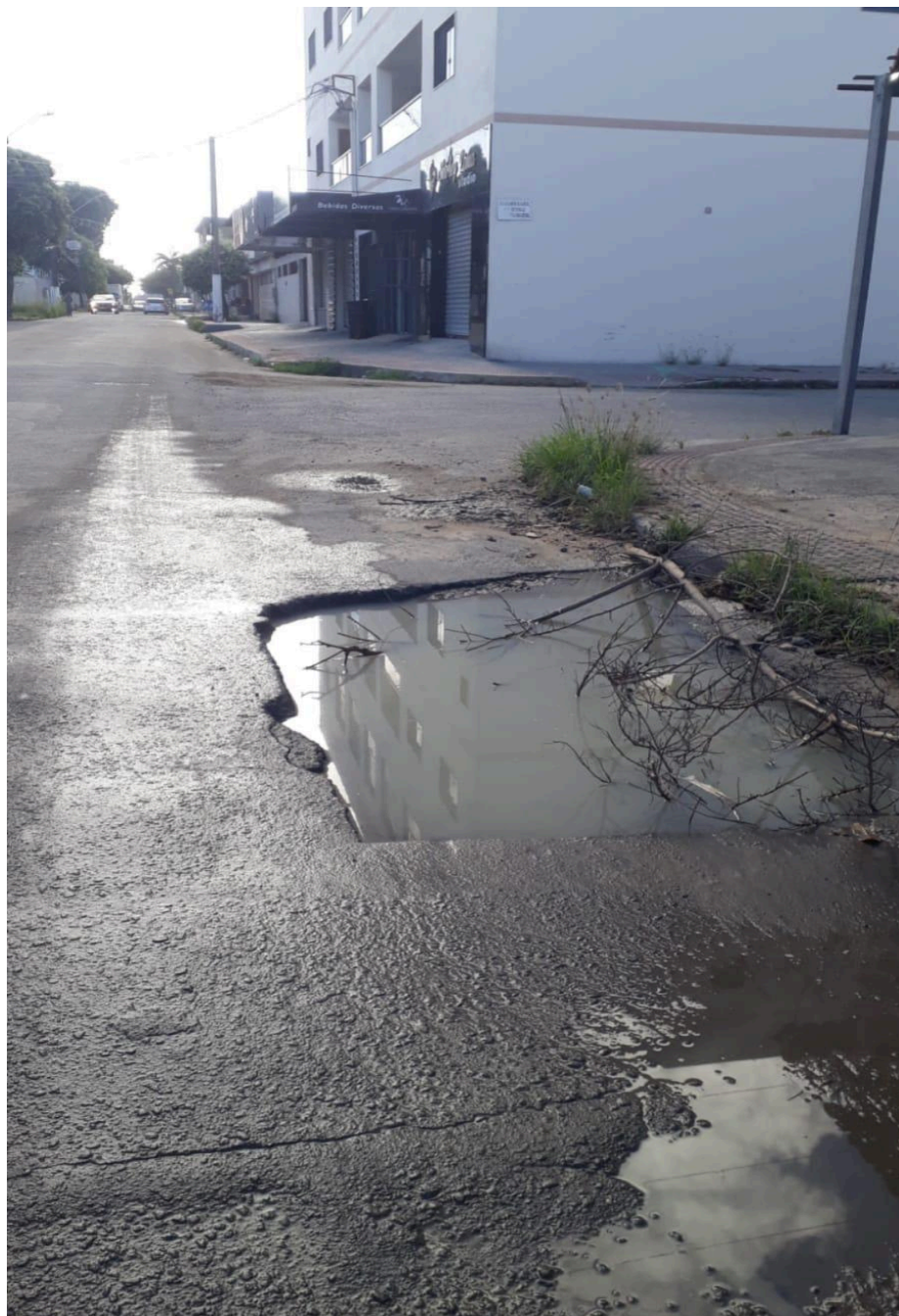
Imagem 3 - Vista do buraco, Rua Gustavo Barroso, s/n, Chácara Parreiral, Serra - ES. Fonte: Gabinete.
