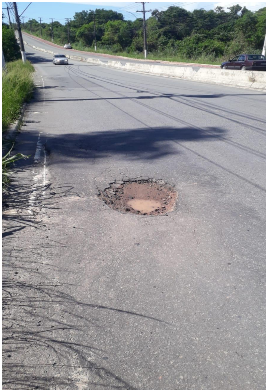
Imagem 3 - Vista do buraco, Av. Norte Sul, S/N, Colina de Laranjeiras, Serra - ES. Fonte: Gabinete.
