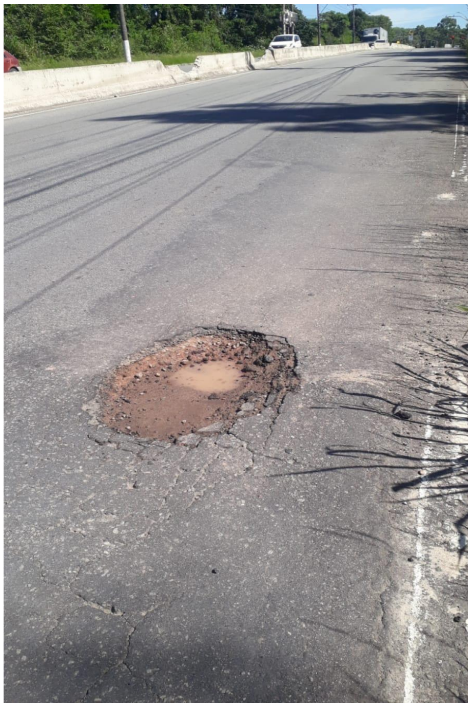
Imagem 2 - Vista do buraco, Av. Norte Sul, S/N, Colina de Laranjeiras, Serra - ES. Fonte: Gabinete.
