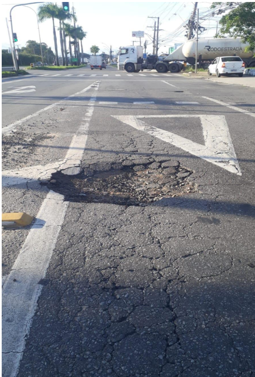
Imagem 3 - Vista do buraco, Avenida Mestre Álvaro, S/N, Taquara II, Serra - ES. Fonte: Gabinete.
