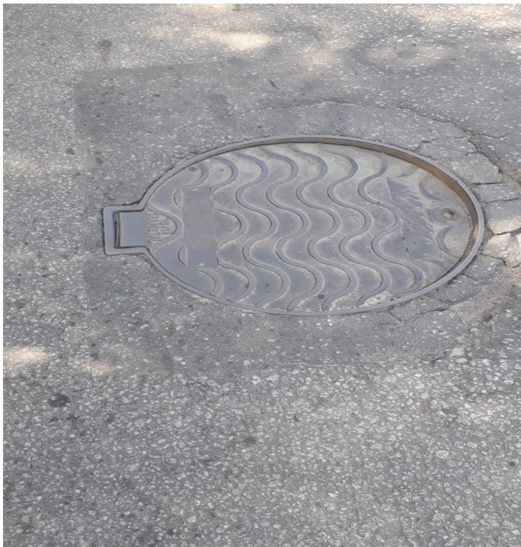
Imagem 2 - Vista da tampa desnivelada na Av. Norte Sul, Taquara II, Serra - ES. Fonte: Gabinete.
