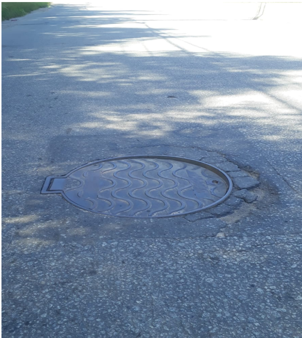
Imagem 3 - Vista da tampa desnivelada na Av. Norte Sul, Taquara II, Serra - ES. Fonte: Gabinete.
