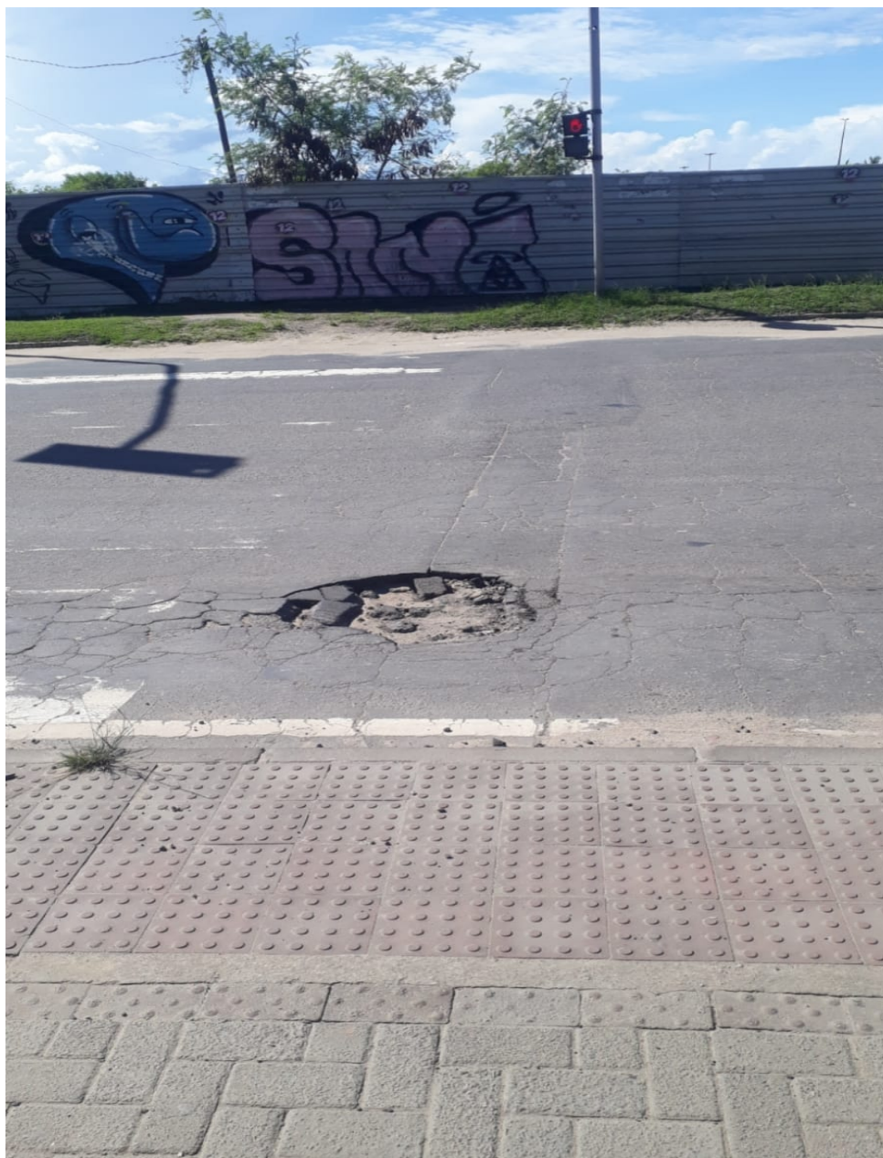
Imagem 2 - Vista do buraco, da rua 3D, S/N, Civit II, Serra - ES Fonte: Gabinete.
