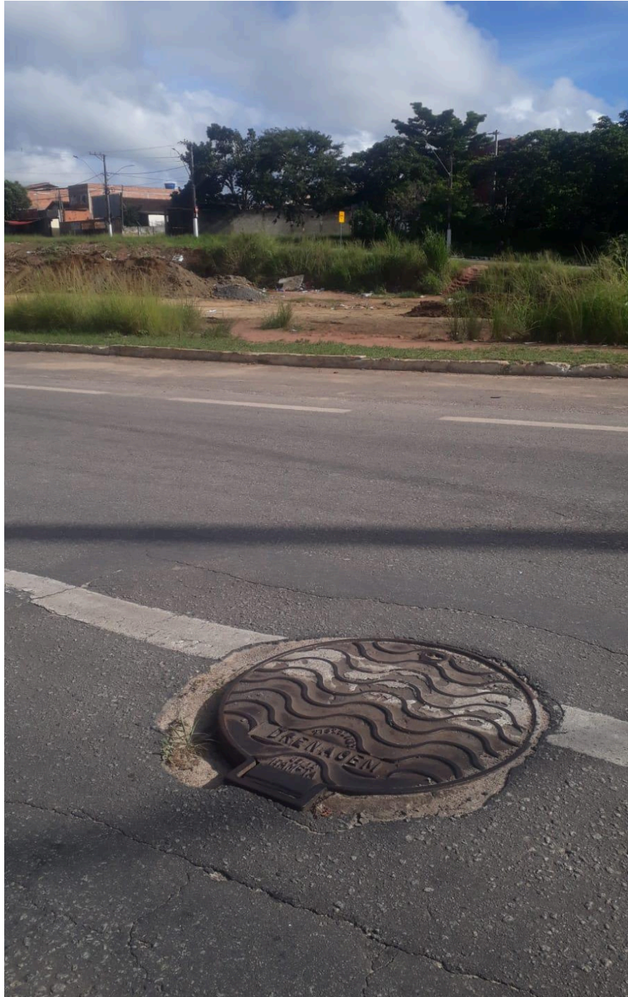
Imagem 2 - Vista da tampa na Rua 4D, s/n, Civit II, Serra - ES. Fonte: Gabinete.
