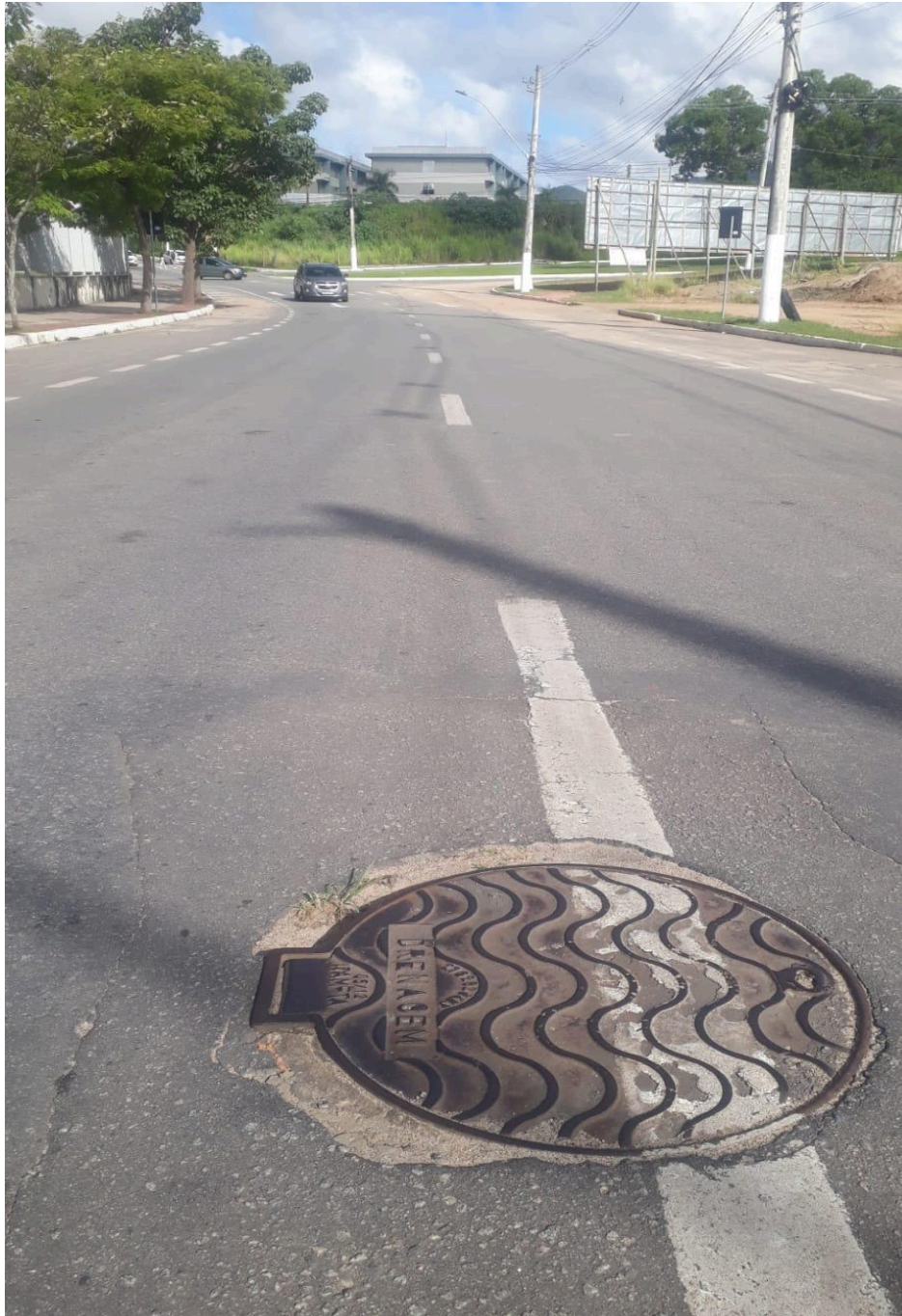
Imagem 3 - Vista da tampa na Rua 4D, s/n, Civit II, Serra - ES. Fonte: Gabinete.
