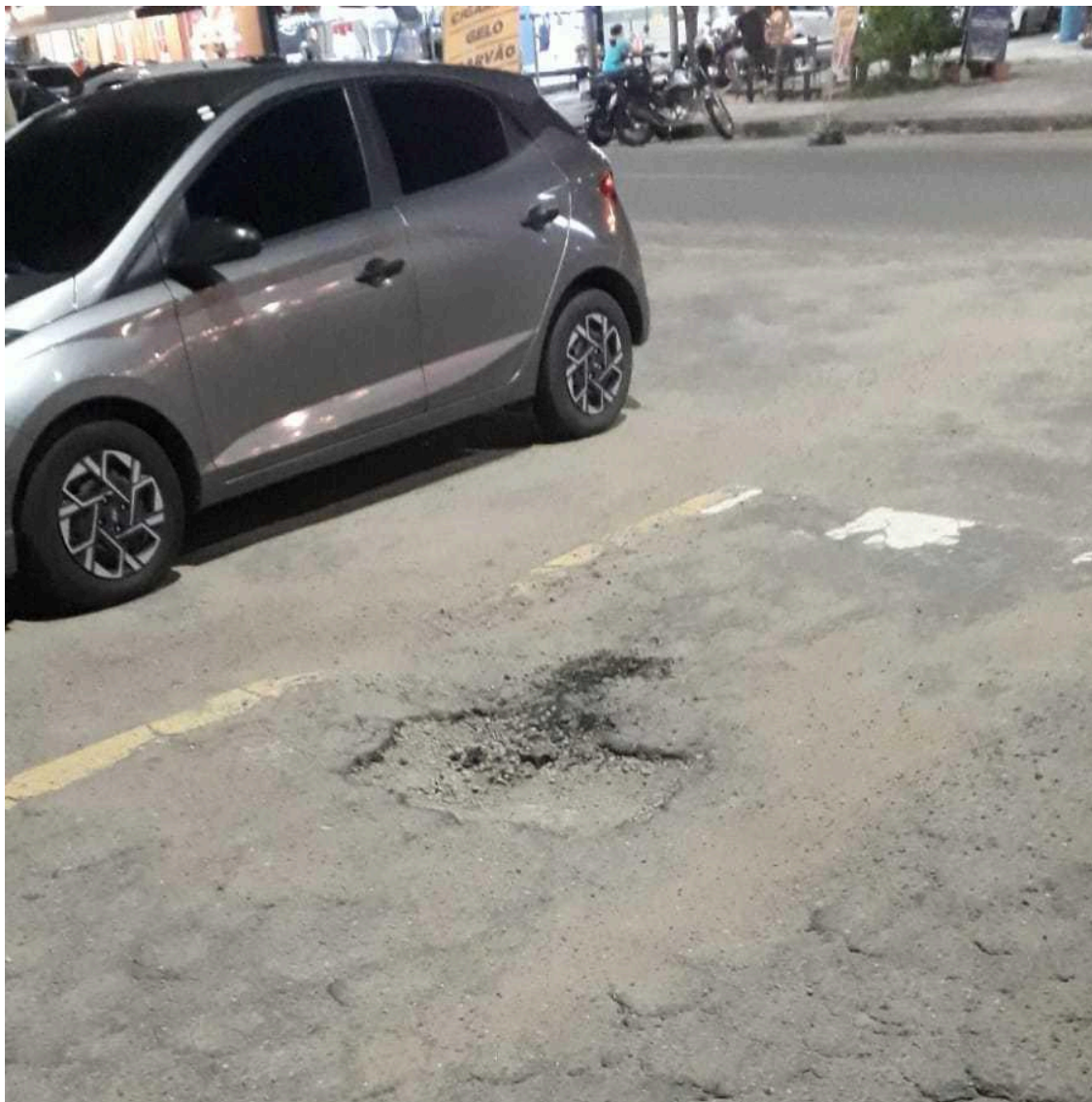
Imagem 1 – Localização do buraco na Rua Imbirema. Fonte: Município.
