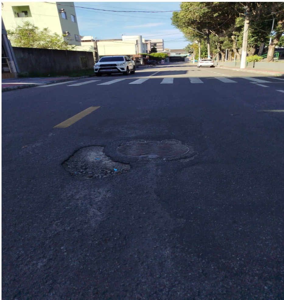
Imagem 1 – Localização do buraco na Avenida Monte Líbano. Fonte: Gabinete Externo.
