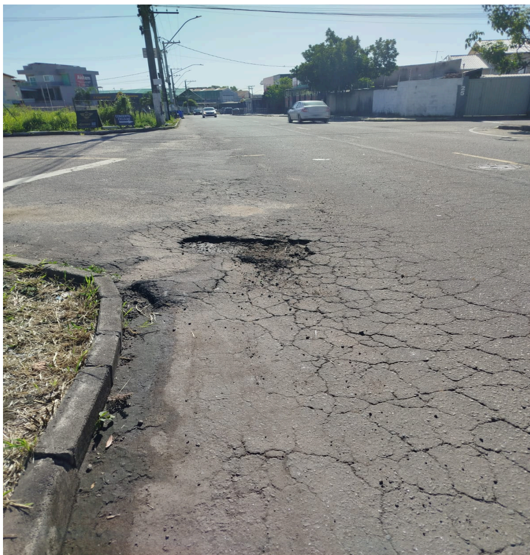
Imagem 1 – Localização do buraco na Avenida Braúna. Fonte: Gabinete Externo.
