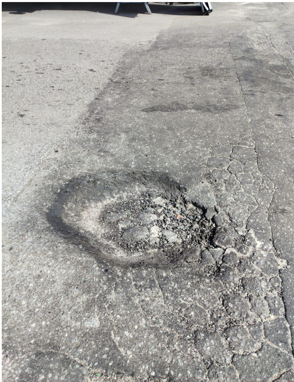
Imagem 2 – Localização do buraco na Av Braúna. Fonte: Gabinete Externo.
