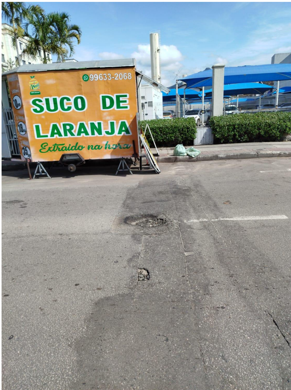
Imagem 1 – Localização do buraco na Av Braúna. Fonte: Gabinete Externo.
