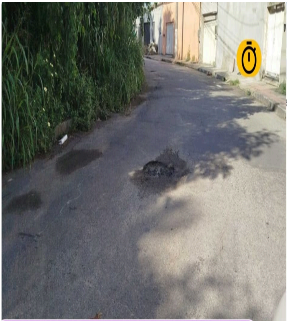
Imagem 2 – Localização do buraco na Rua Monte Morá. Fonte: Gabinete Externo.
