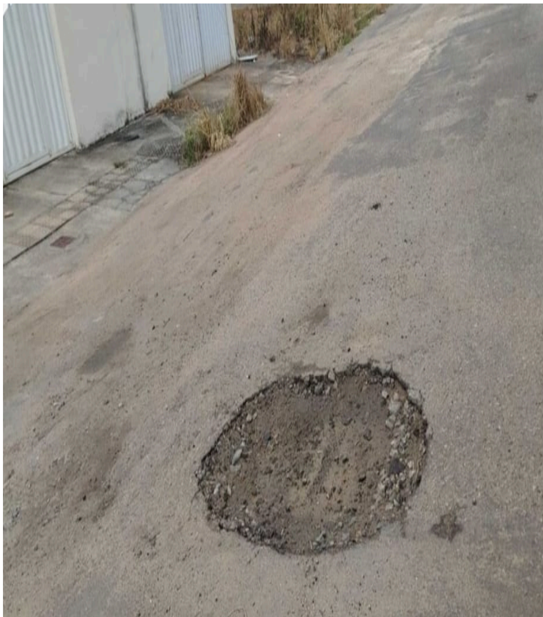
Imagem 3 – Localização do buraco na Avenida Macanaíba. Fonte: Gabinete Externo.
