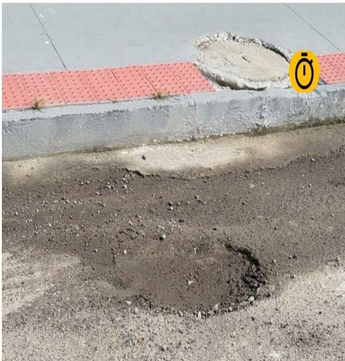
Imagem 1 – Localização do buraco na Rua Jacarandá. Fonte: Gabinete externo.
